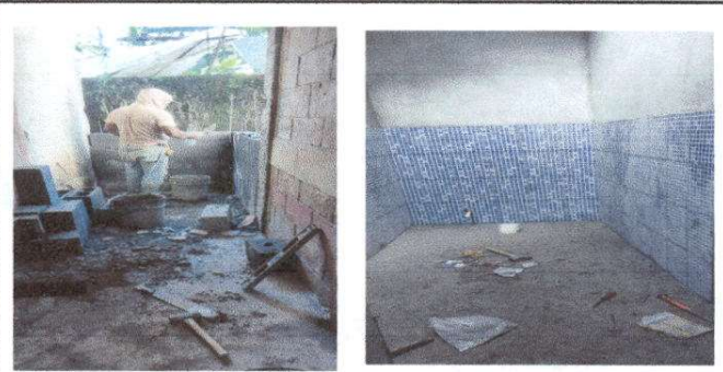
Foto 6: Servicios Sanitarios y Accesorios
